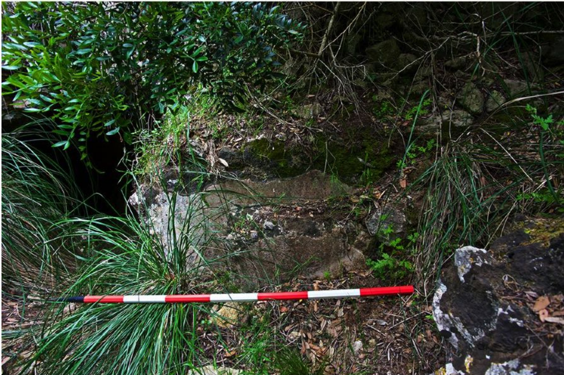
(Fig. 8) Contrafforte della cisterna crollata
